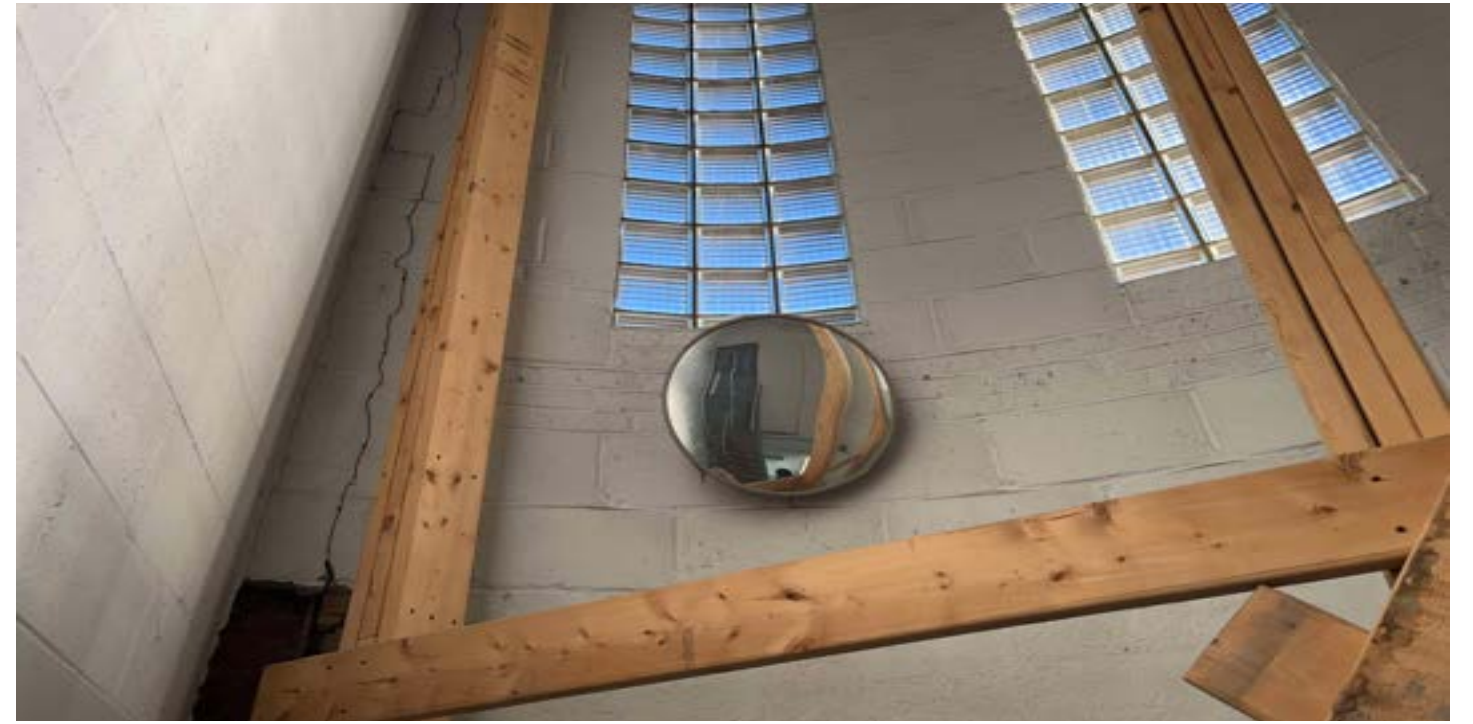
Figure 11 : Le mur est fissuré
